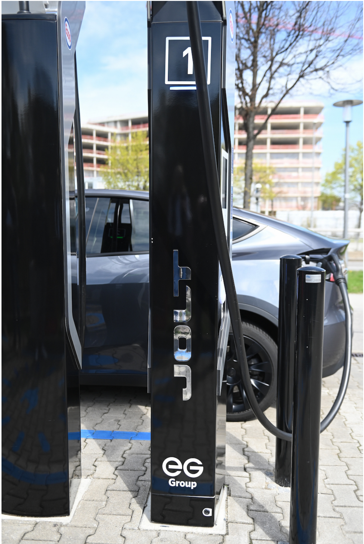
JOLT-Elektro-Schnellladestation in München
